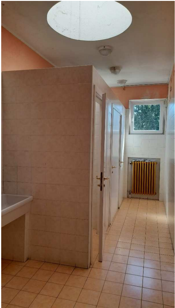
Figura 3_Stato attuale Servizi igienici piano primo da modificare per inserimento bagno disabili
